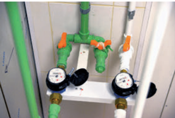
A la izquierda, el medidor del volumen de agua potable (verde) de la bomba de vacío y, a la derecha, el medidor que registra el volumen de agua del sistema de ósmosis inversa (blanco), exclusivo para limpieza de materiales, equipamiento de desinfección térmica y esterilización.
