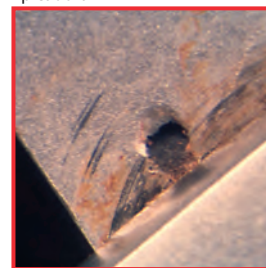
Ejemplo de corrosión de picadura
