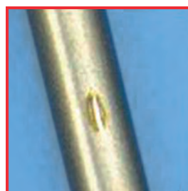
Corrosión de contacto: Acero inoxidable/Acero inoxidable
