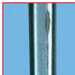
Corrosión de contacto: Acero inoxidable/latón
