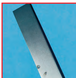
Ejemplo de corrosión de picadura
